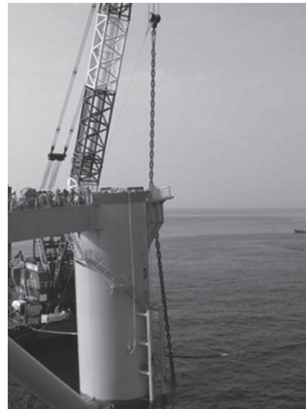
写真一7 500t吊クレーン台船による係留チェーン引上げ作業の状況
