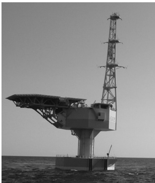
図 24 稼働中の洋上サブステーション
